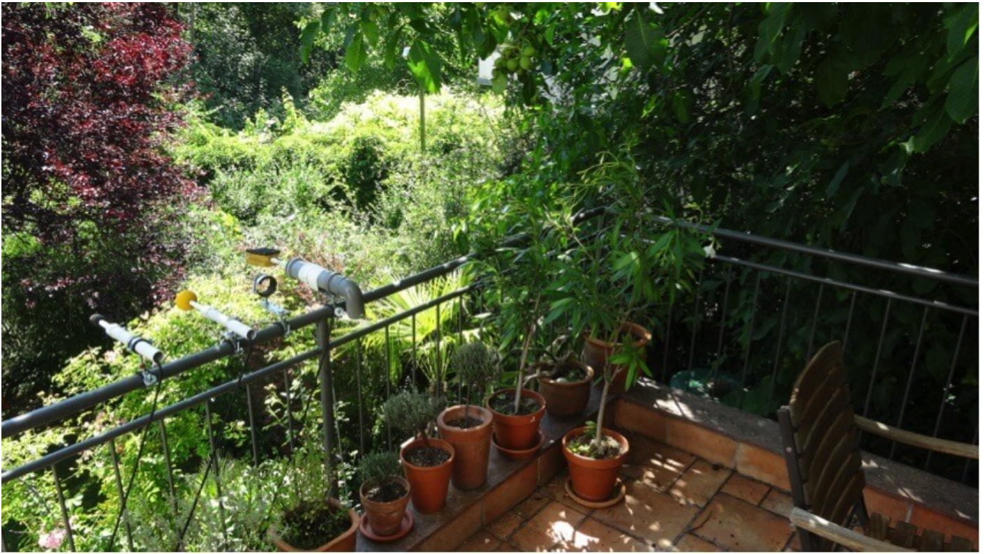
Verschiedene Bauweisen von Lärmsensoren im Grünen installiert
